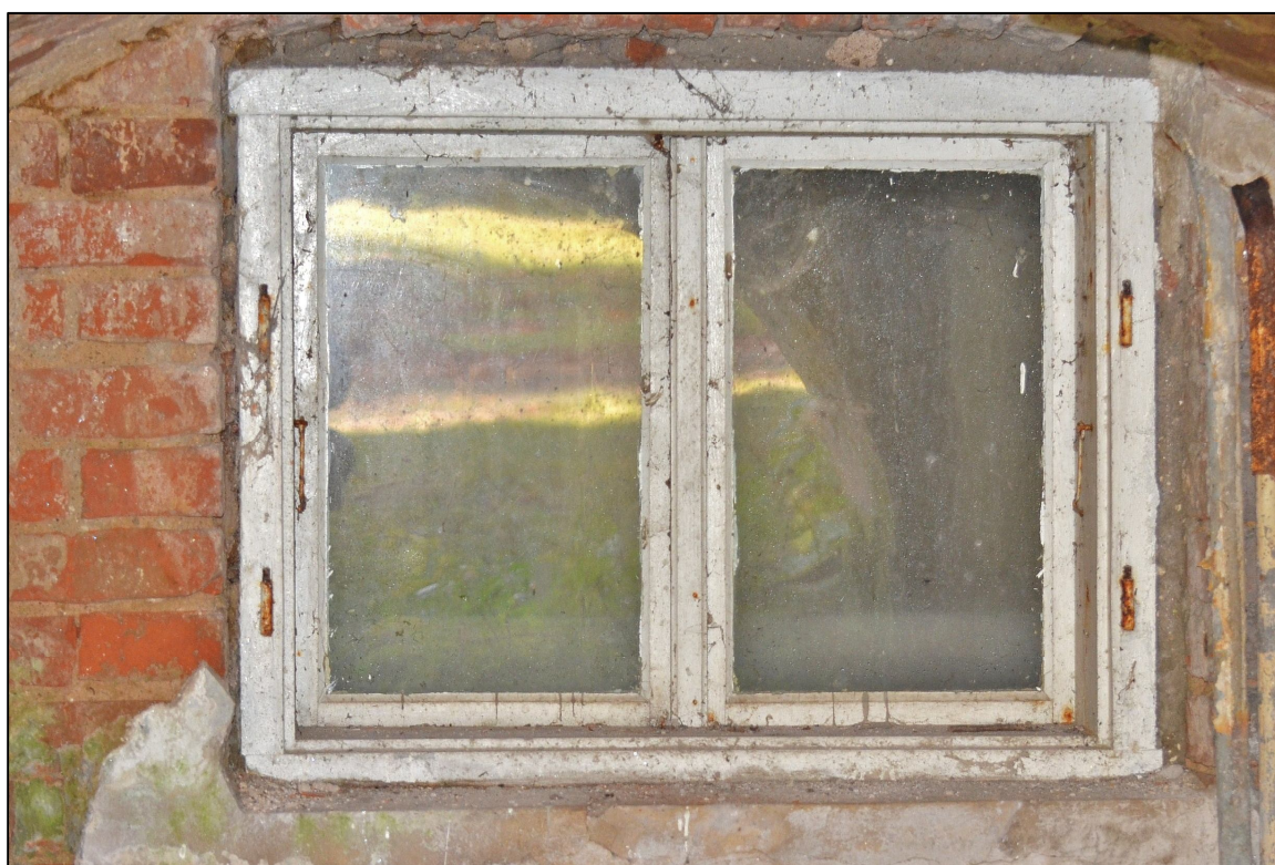
II. 17 Wieniec, Pałac – piwnica – elewacja wschodnia - widok na awers stolarki okiennej TYP I A – okno nr 41 – brak skrzydeł wewnętrznych
