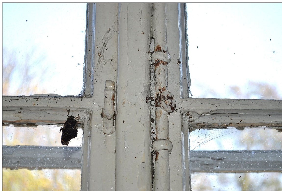
II. 127 Wieniec, Pałac – I piętro - stolarka okienna TYP VB i C – widok na zawrotnicę pozbawioną zakrętki
