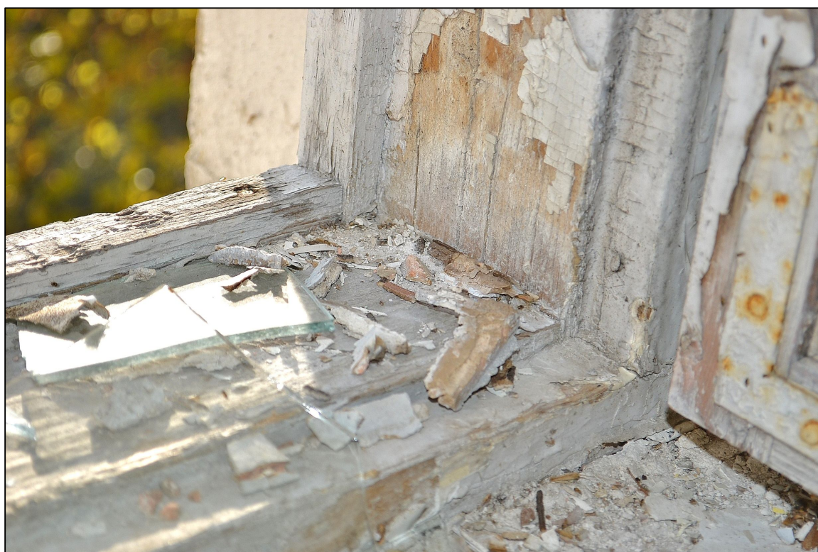
II. 153 Wieniec – Pałac – I piętro - elewacja zachodnia - stolarka drzwiowa TYP VI – widok na zniszczone oboknie i ramiaki
