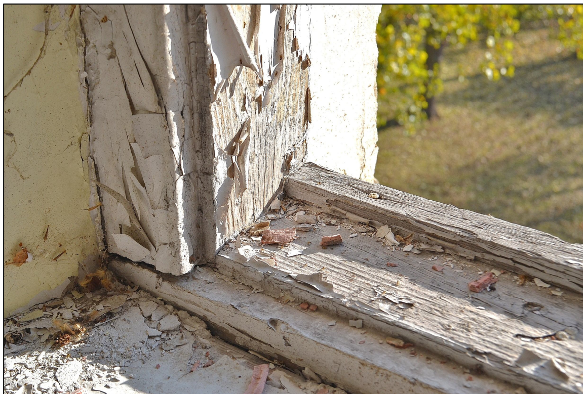
II. 156 Wieniec – Pałac – I piętro - elewacja zachodnia - stolarka drzewiowa TYP VI – widok na zniszczone oboknie i ramiaki
