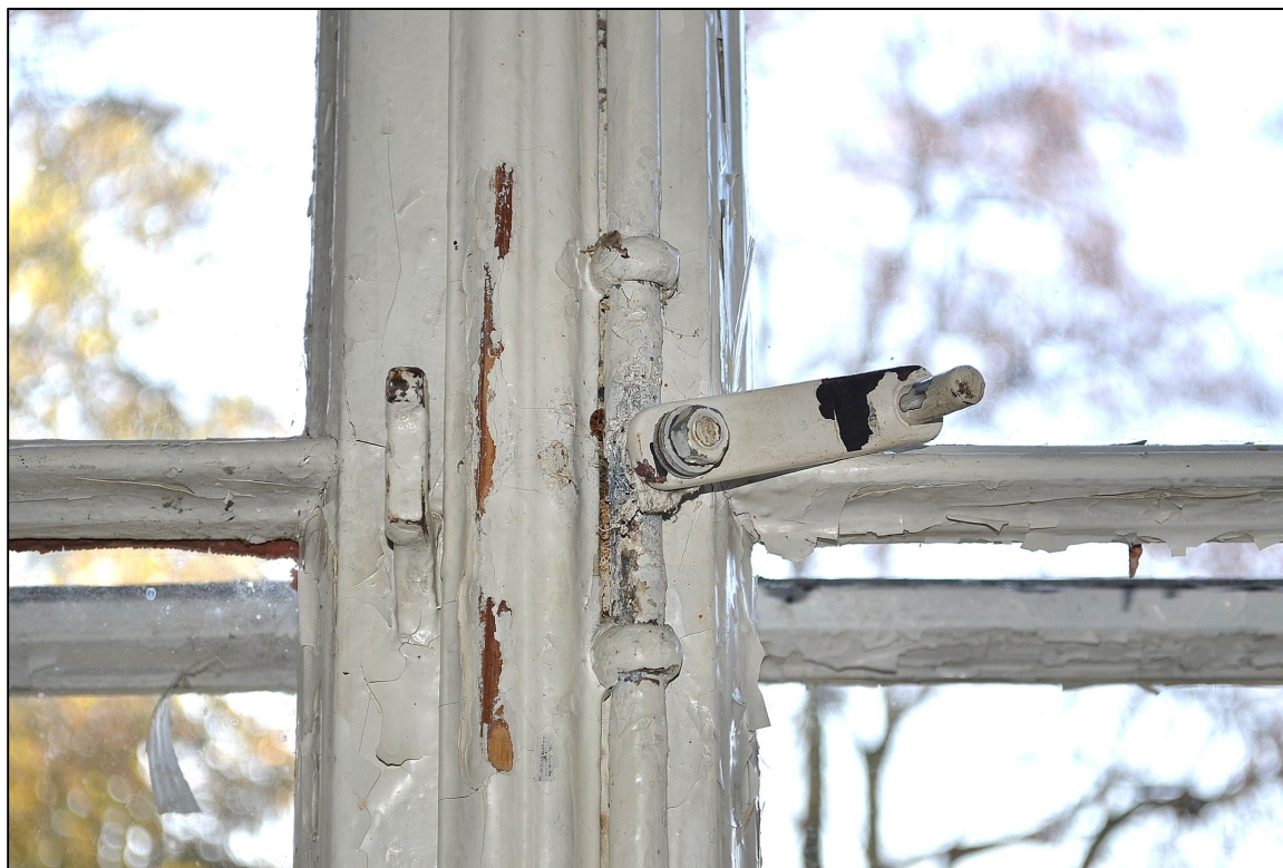
II. 126 Wieniec, Pałac – I piętro - stolarka okienna TYP VB i C – widok na zawrotnicę uszkodzoną
