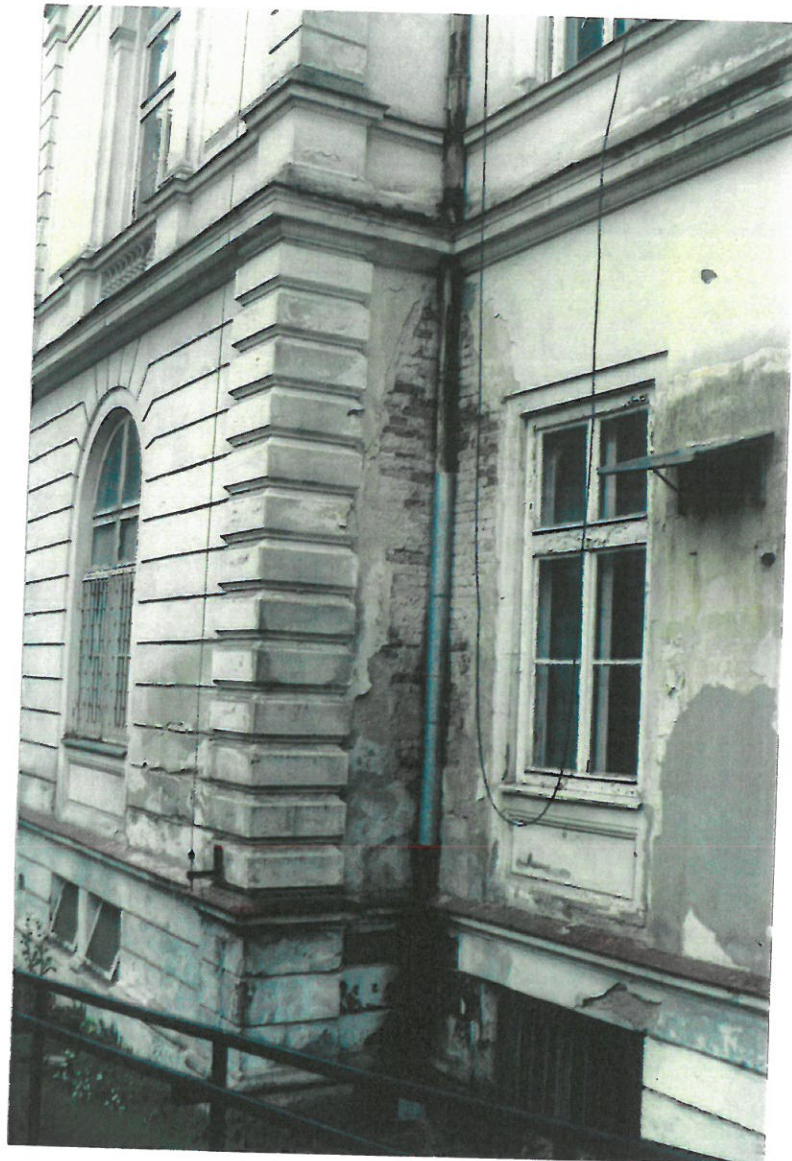
Fot. nr 8 Pokazano tu jedną z przyczyn zawilgocenia ścian.
