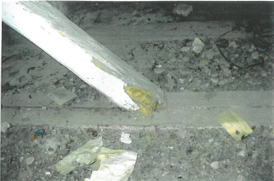
Fot. nr 14 Uszkodzona przez owady krokiew i widok szlaki
