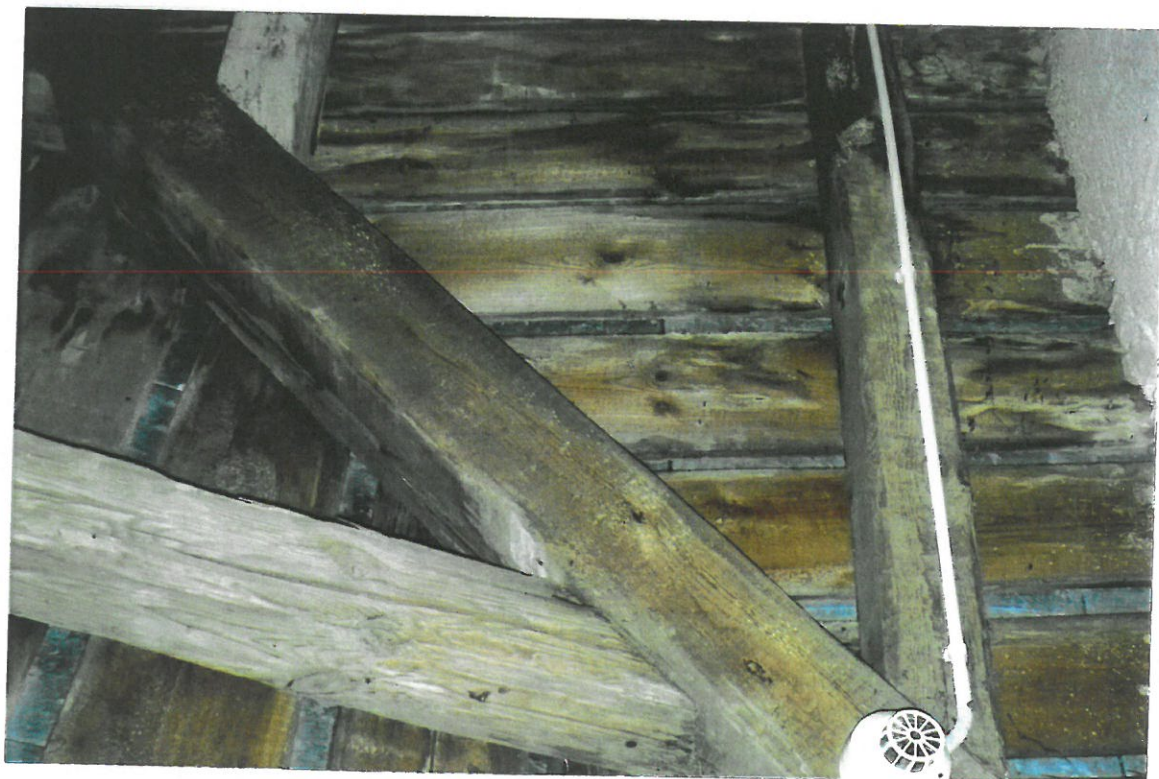
Fot. nr 15 Wielokrotnie zawilgocona więźba
