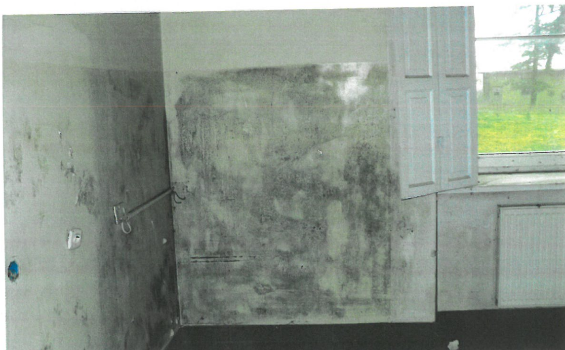
Fot. nr 10 Porażona przez pleśń ściana
