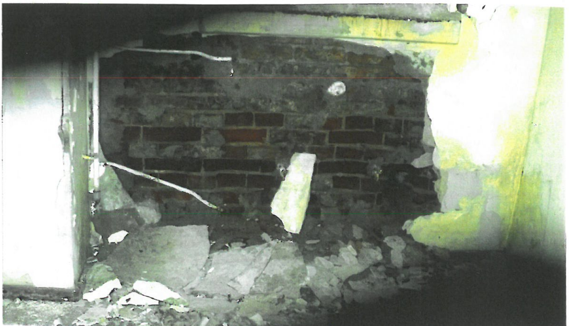
Fot. nr 5 Zawilgocony i zdewastowany fragment ściany.
