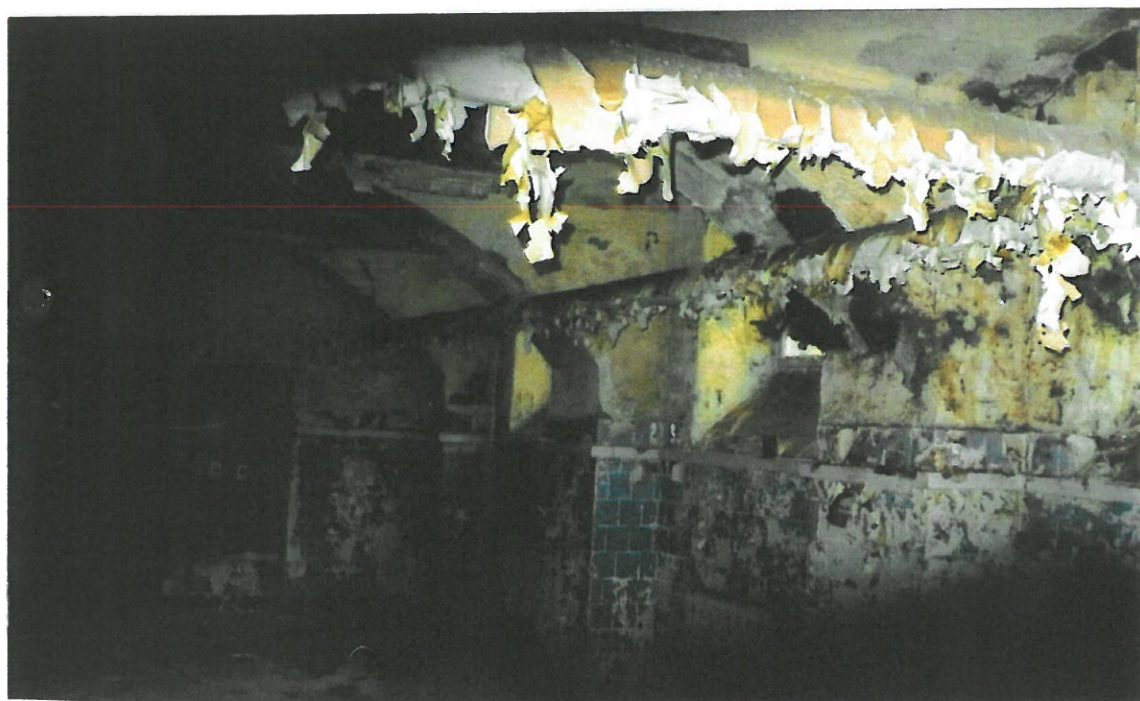
Fot. nr 7 Dewastacja pomieszczenia nadmiarem wilgoci
